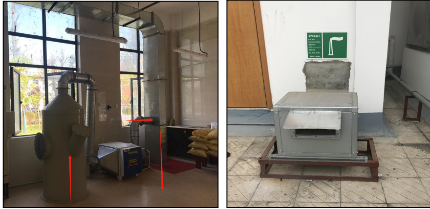
图 4-3 恶臭处理装置及排气筒
