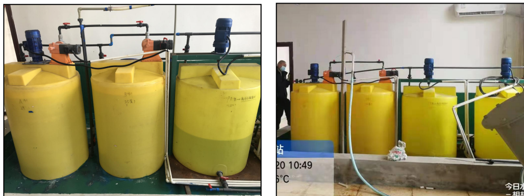
图 4-7 污水处理站消毒剂加药箱
