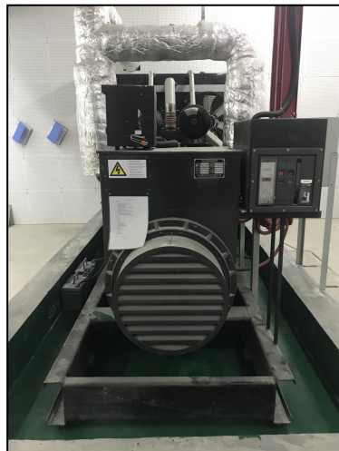
图 4-4 柴油发电机及消烟除尘装置
